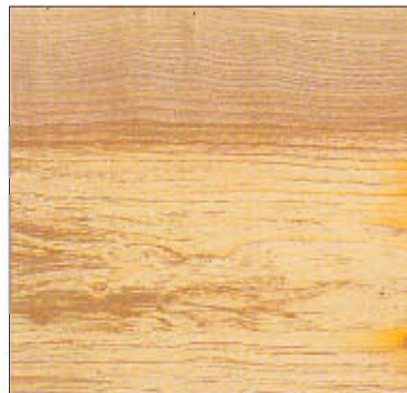
Madera atacada por hongos.
