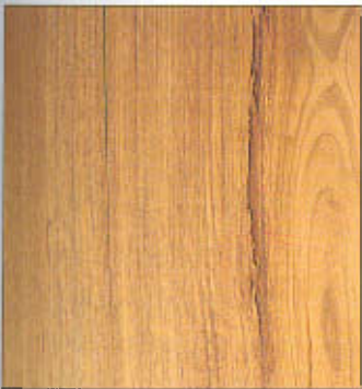
Madera con grietas.
