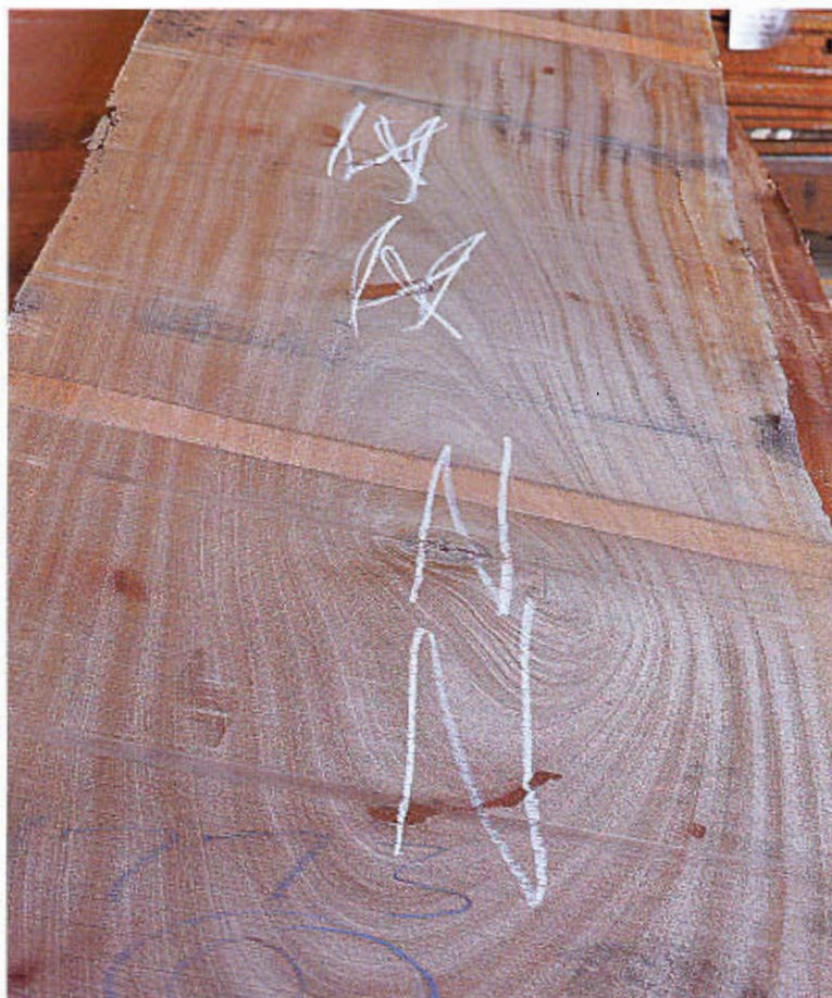
Al comprar madera examine los defectos visibles en la misma.
