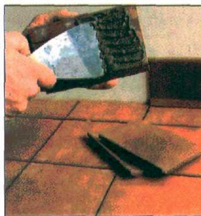
При приклеивании бордюрной плитки клей наносится на ее обратную сторону. Излишки клея сразу же вытираются.
