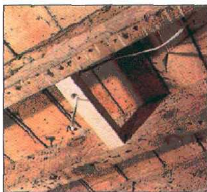
3. Электропровод укладывается на потолок и выводится через отверстие в поперечной решетине. Крюк для люстры ввинчивается в древесину.
