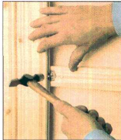
Специальными гвоздями длиной 20 или 25 мм (в зависимости от толщины каркаса) скоба прибивается к рейке.
