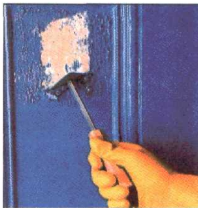
Растворитель наносится на небольшие участки поверхности; шабером или шпателем размягченная краска удаляется.
