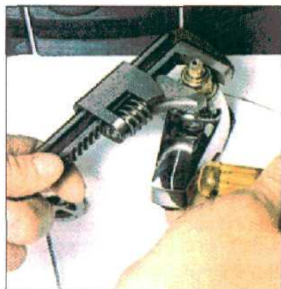
При отсоединении верхней части корпуса крана держите крепко, чтобы не повредить металл щечками разводного ключа.
