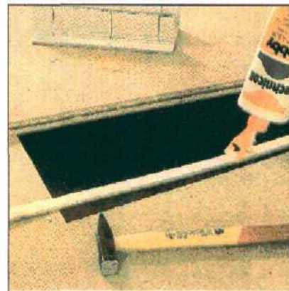
Вставьте подходящую фанерную полосу с нанесенным в паз клей и соедините обе половицы.
