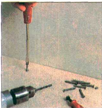
Неровное основание застилается 12-миллиметровыми водостойкими ДСП, прежде чем вы начнете укладывать плитку.
