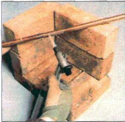
Пламя паяльной лампы разогревает материал до красного каления. При работе с лампой используйте ограждение из кирпича или шамотного камня.
