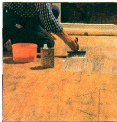
Очищенный пол надо грунтовать: это улучшит его сцепление с заливкой. Грунтовочный состав разбавляют водой в пропорции 1:1.
