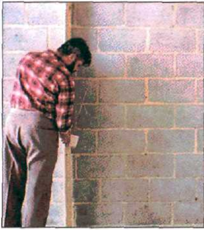
1. Вспомогательной рейкой отметьте положение отдельных опор. Уже на этом начальном этапе используйте уровень.
